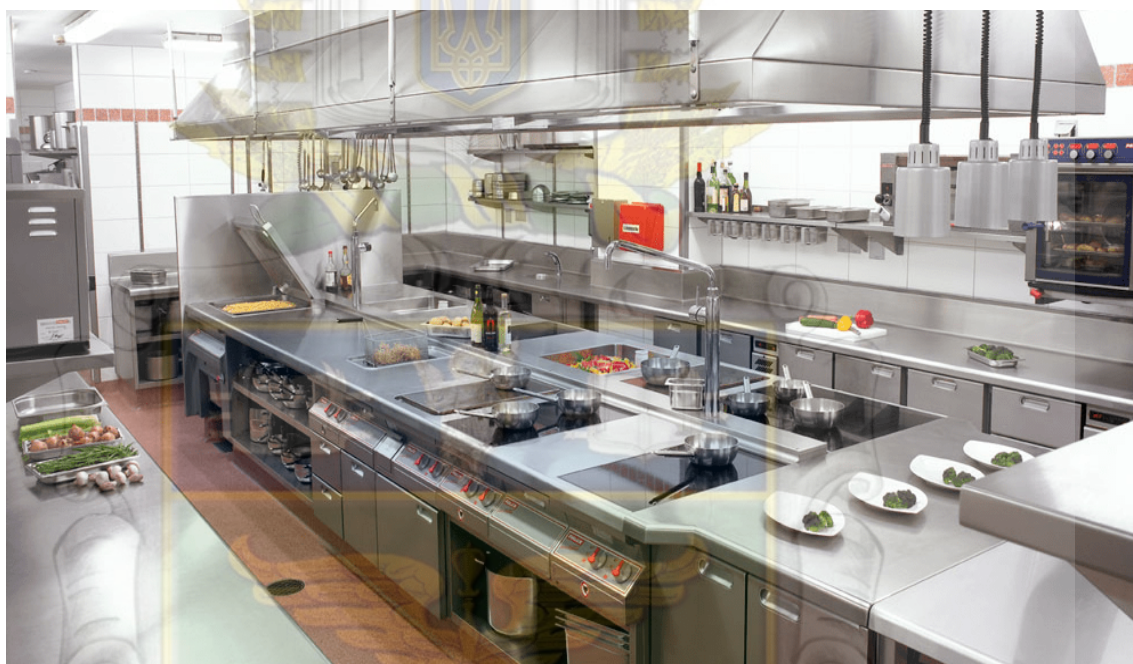
Рисунок 3.3 – Основне обладнання ресторану «Хочу з'їсти&Реберня на Михайлівській»
